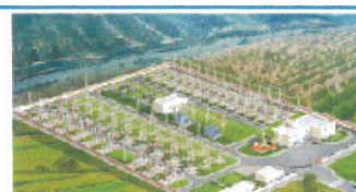
变电站 厄瓜多尔500KV超高压及230KV输变电项目
